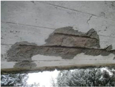
Synlig armeringsjern på undersiden av dekke.
