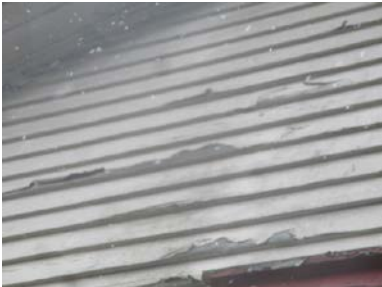
Slitt gavlvegg og maling har løsnet.
