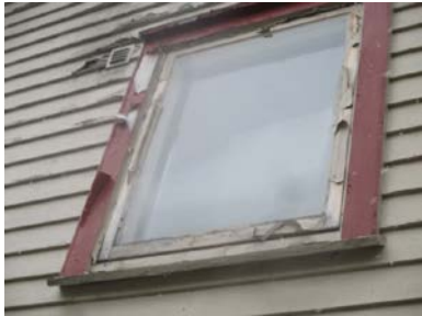
Maling har løsnet på flere vinduer.
