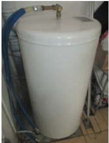
Bereder er plassert på vaskerommet
