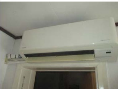
Varmepumpe i kjellerstue
