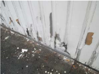
Større råteskader på utfored grunnmur
