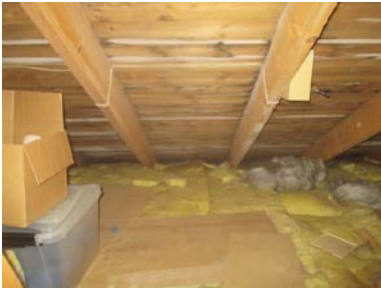
Bør åpnes opp for mer tilgang på luft i fra gesimser.
