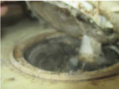
Sluk under dusjkabinett
