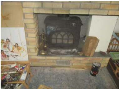
Vedovn er plassert i åpen peis i kjellerstue.
