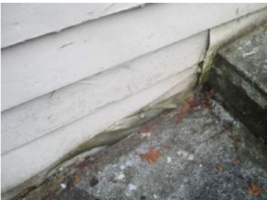
Fuktutsatt punkt i mot veranda.
