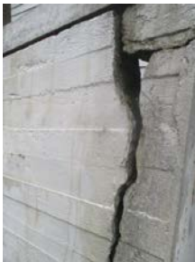
Større sprekk i forstøtningsmuren.
