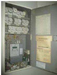
Sikringsskapet i gangen i hovedetasjen.
