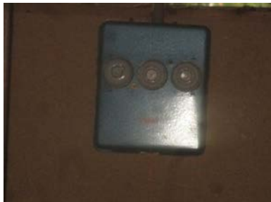
Inntakssikringer på kaldtloftet
