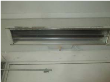
Eldre sråleovn som varmekilde.
