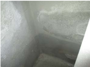
En del salutslag og fuktmerker i nedre del av grunnmur.
