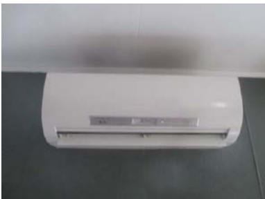
Varmepumpe i stue
