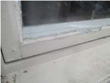
En god del utvendig vedlikehold må beregnes.
