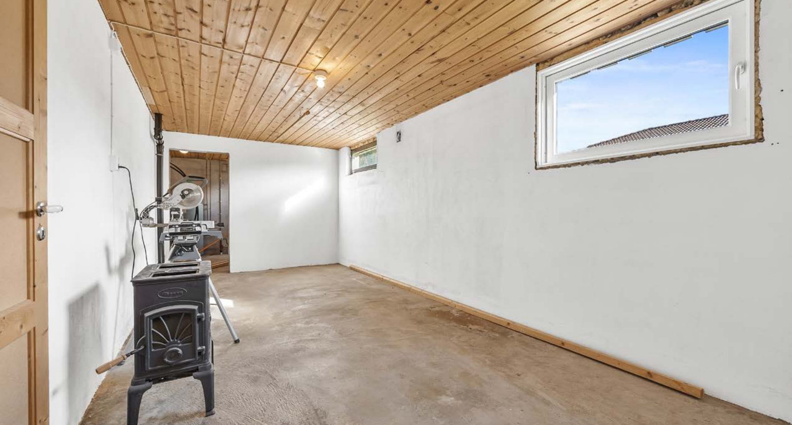
Ett av rommene i underetasjen er bruksendret til soverom, men benyttes i dag som bod.
