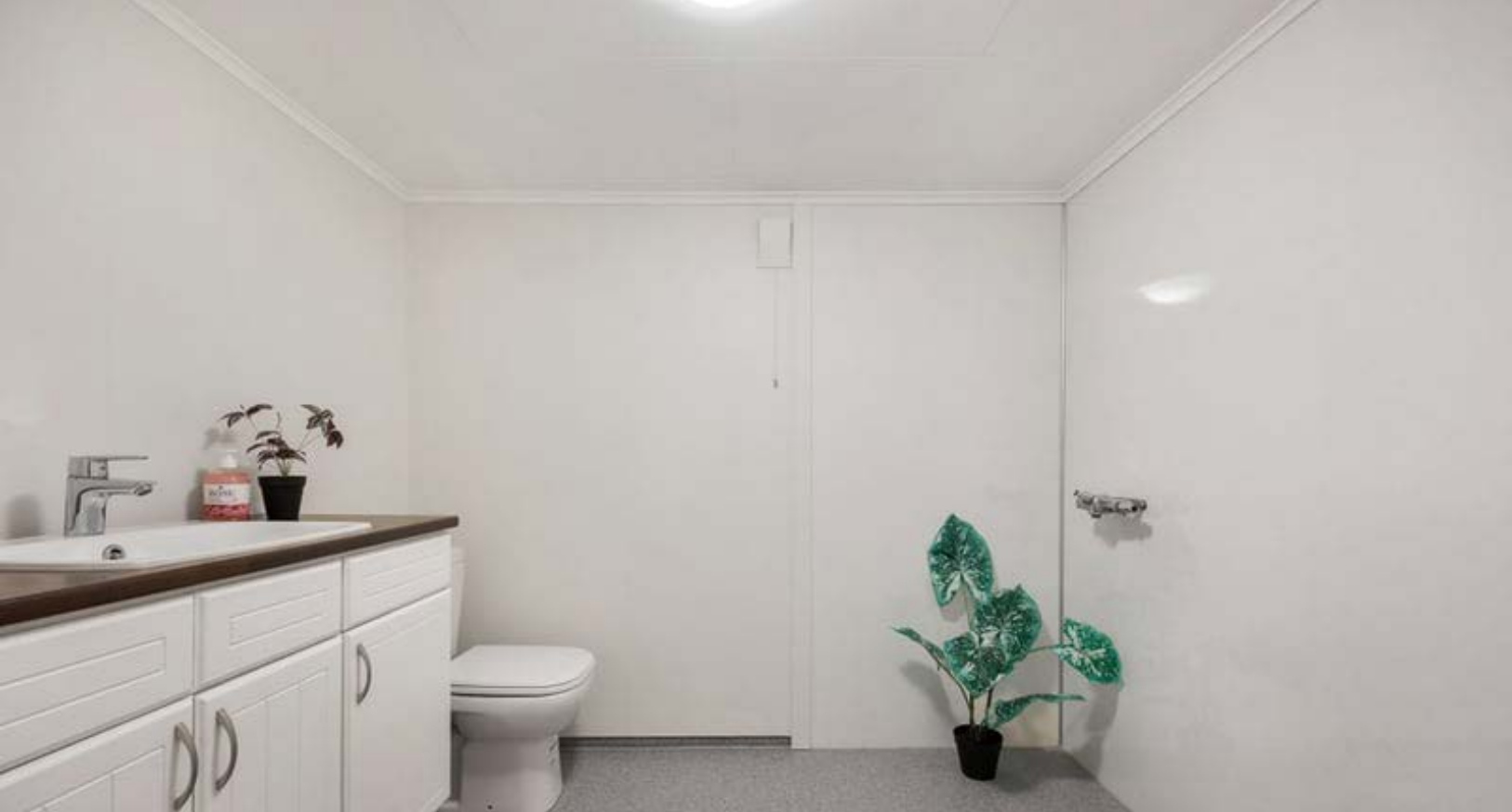
Wc-rommet i kjelleren har gulvbelegg, våtromsplater og et stort servantskap. Toalettet er ikke montert tilstrekkelig, ikke tilkoblet vann og er derfor ikke i funksjon.
