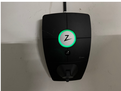
El. bil ladestasjon v/ garasje plass.
