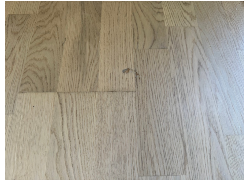
Slitasje/striper i parkettgulv i stue/kjøkken.
