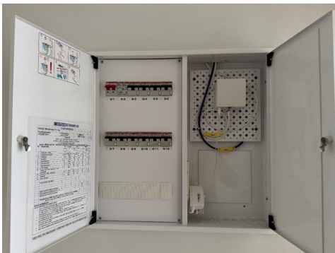
Sikringskap i bod/teknisk rom.
