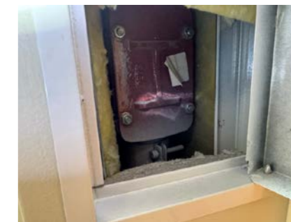
Stakeluke på soverom.
