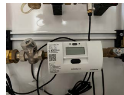
Forbruksmåler i rør i rør skap.
