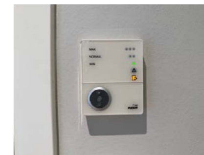
Bryterpanel i entre/gang. Bør stå på maks effekt v/ dusjing.
