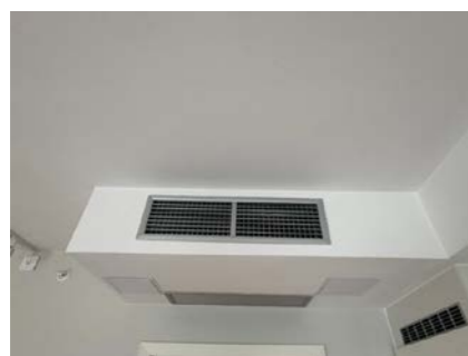
Viftekonvektor i stue/kjøkken.
