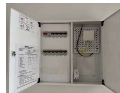
Sikringsskap i bod/teknisk rom.
