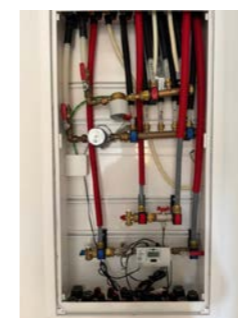
Ingen tegn til fukt/kondens i rør i rør skap. Rør i rør skap bør sjekkes for ev. lekkasje 2 ganger årlig.
