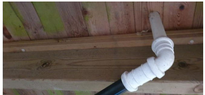
Løse, uisolerte rør
