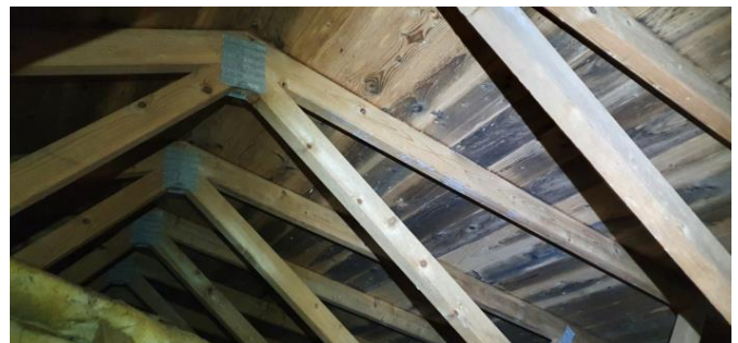
Noe svartsopp og fuktmerker
