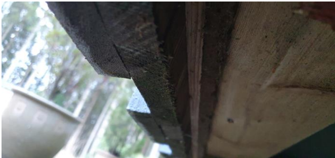
Manglende lufting bak kledning
