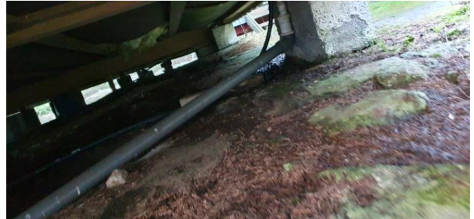
Løse, uisolerte rør
