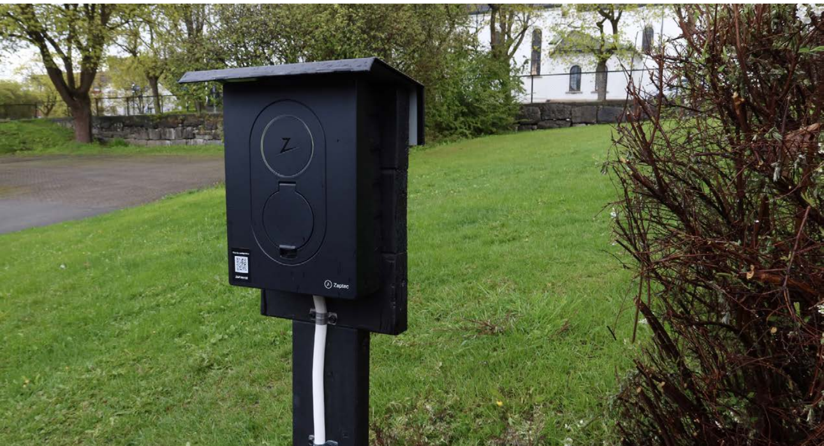
Nylig installert elbil-lader som medfølger i handelen.
