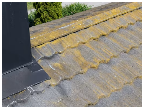
Det registres bulker i takplater.
