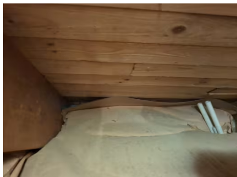
Stedvis redusert lufting i raft.
