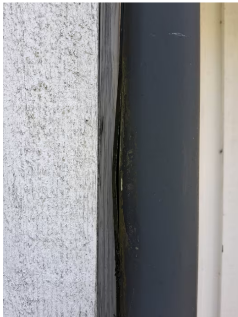
Det registreres buling på enkelte nedløpsrør.
