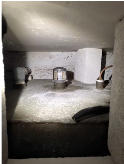
Oljetank er plassert i kjeller.
