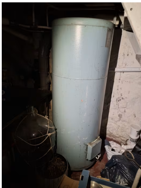
Varmtvannsbereder er plassert i kjeller.
