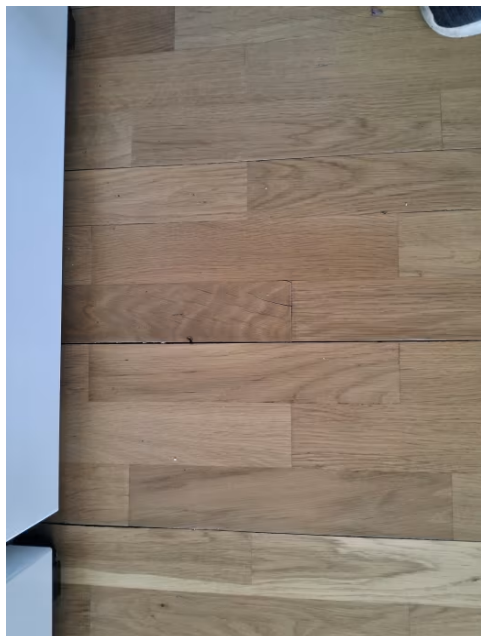
Parkettgulv har svelleskader ved kjøleskap.
