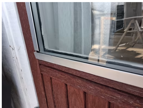
Det registreres punktert glass i balkongdør.
