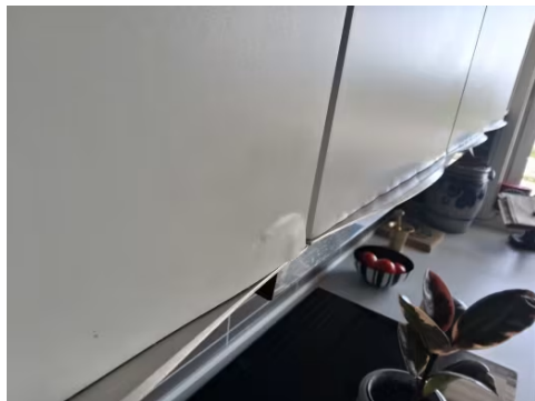
Svelleskader på kjøkkenfronter.
