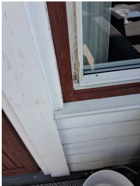
Det registreres værslitte vinduskarmer.
