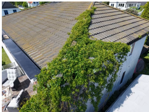
Klatreplante har spredd seg over taket.
