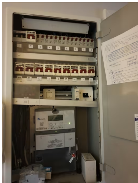
Sikringsskap er plassert i gang.
