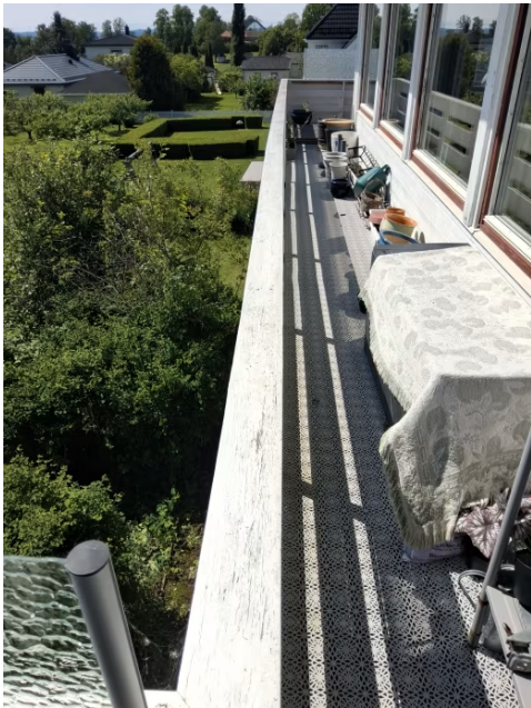
Det registreres skjevheter i rekkverket.
