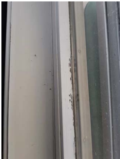
Det registreres tegn til kondens i form av krakelert maling på enkelte vinduer.
