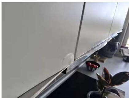
Svelleskader på kjøkkenfronter.
