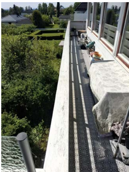
Det registreres skjevheter i rekkverket.
