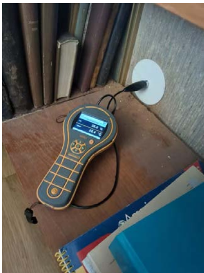
Bilde fra fuktmåling i veggkonstruksjon tilstøtende våtsone.
