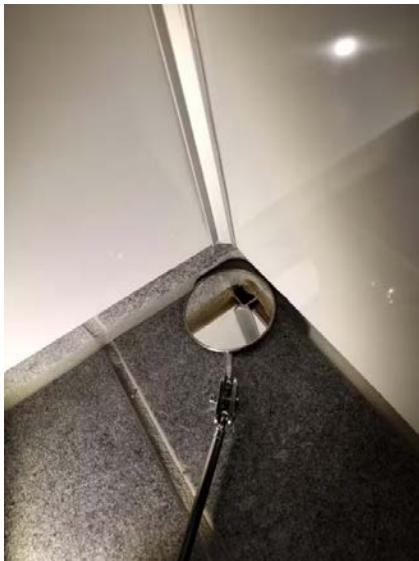
Undersiden av hjørne i dusjsonen er ikke tettet med fugemasse.
