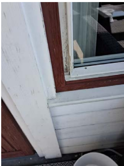
Det registreres værslitte vinduskarmer.
