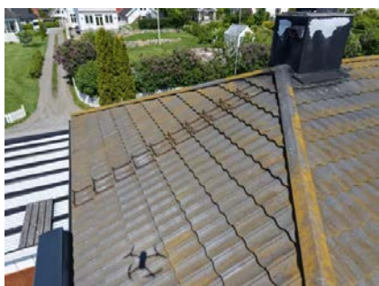
Det er etablert takstige til pipe.
