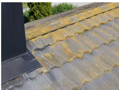
Det registres bulker i takplater.
