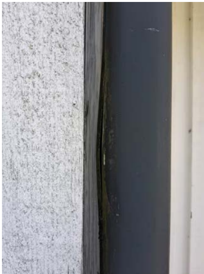
Det registreres buling på enkelte nedløpsrør.
