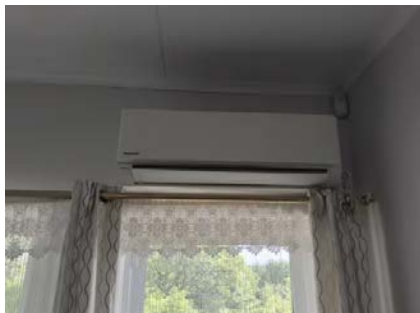
Varmepumpe er plassert i stue i første etasje.
