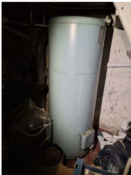
Varmtvannsbereder er plassert i kjeller.
