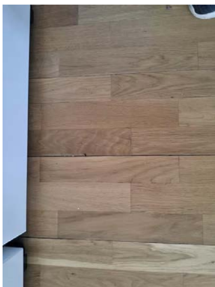
Parkettgulv har svelleskader ved kjøleskap.
