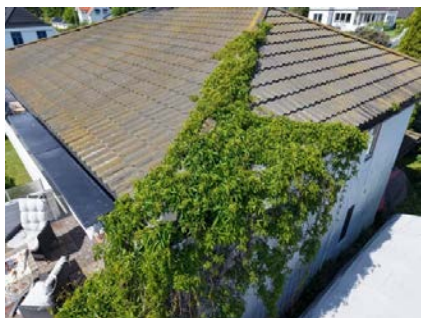
Klatreplante har spredd seg over taket.
