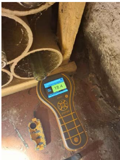
Fuktmåling viser et fuktinnhold opp i mot faren for en skadeutvikling i form av sopp-/råteskader.
