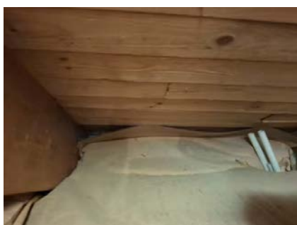
Stedvis redusert lufting i raft.
