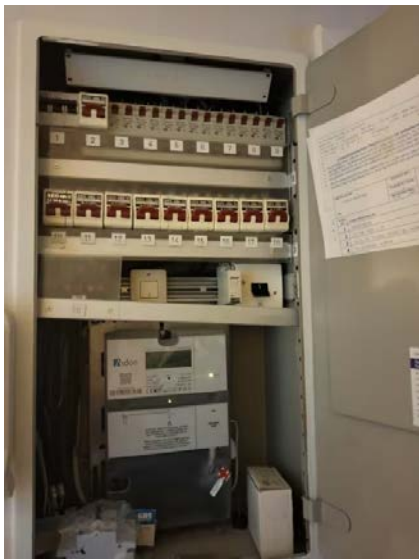
Sikringsskap er plassert i gang.
