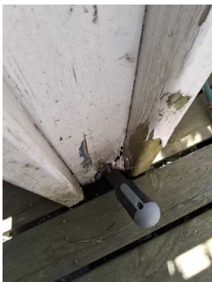
Bilde viser råteskadet søyle.
