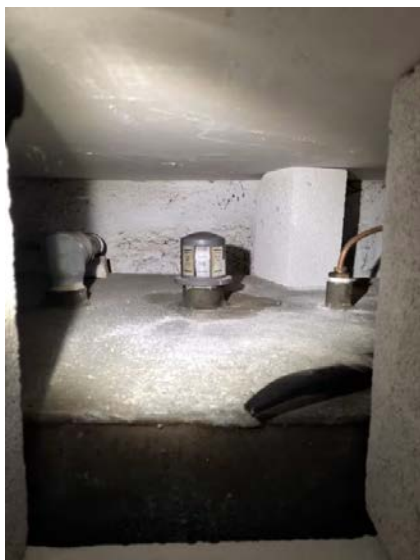
Oljetank er plassert i kjeller.
