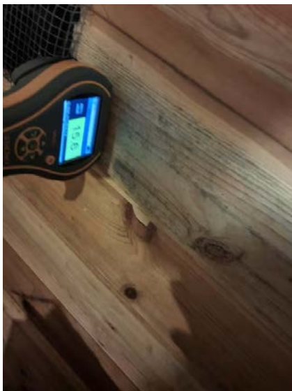
Det ble målt ett fuktinnhold opp i mot faren for en skadeutvikling i form av sopp-/råteskader.
