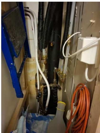
Boligen har synlige vannrør av rør-i-rør og kobber.
