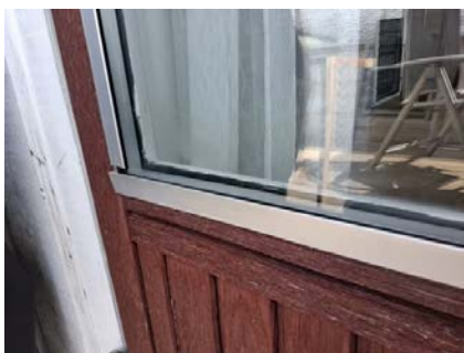
Det registreres punktert glass i balkongdør.
