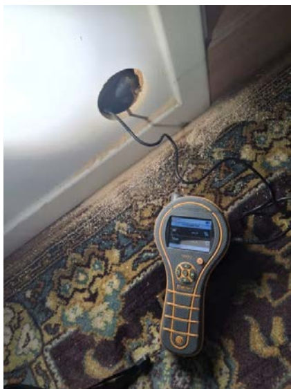
Bilde fra fuktmåling i veggkonstruksjon tilstøtende våtsone.
