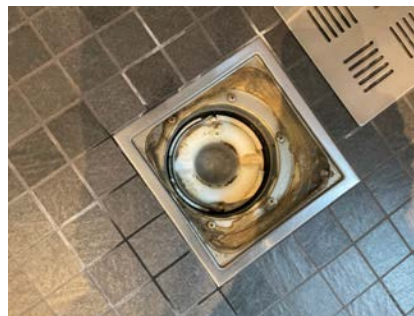
Sluk på baderom 2. etasje
