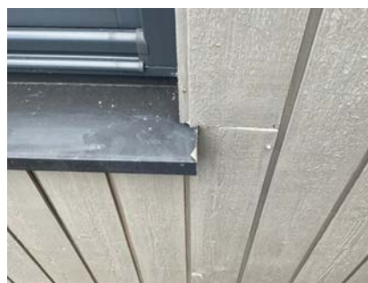
Løs bordkledning ved vindu
