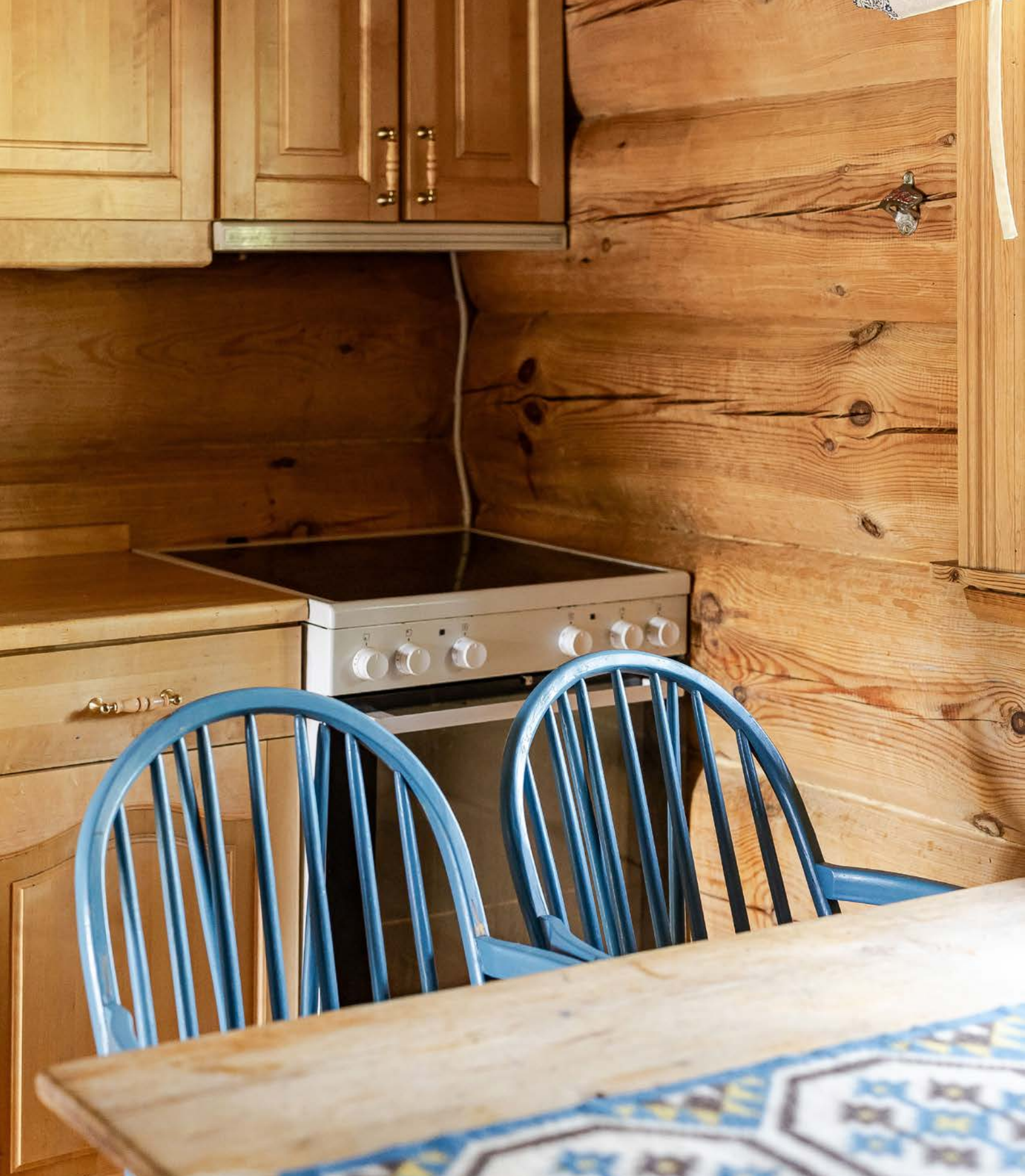
Kjøkkenventilator med avtrekk ut.
