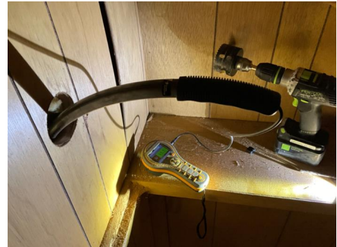
Bilde viser fuktmåling i tilgjengelige materialer fra tilstøtende rom mot våtrommet, på befaringsdagen 11,1 vekt% i trevirket.
