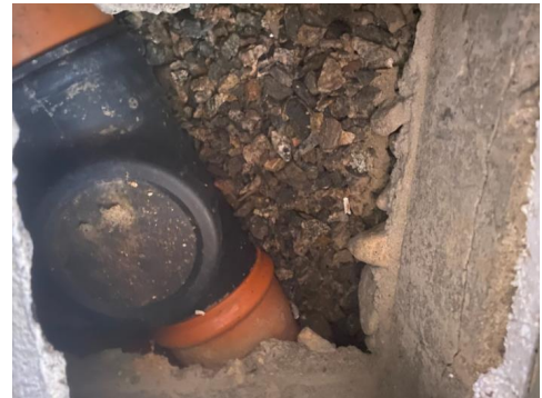
Bilde viser stakeluke på avløpsrør i hull under isopor.
