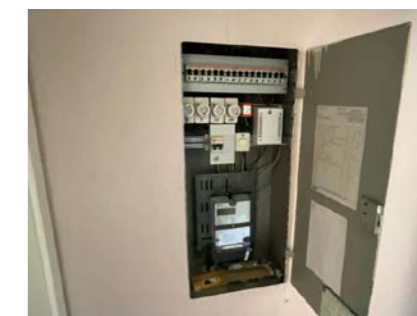
Bilde viser kontroll av el-skap på befaringdagen.
