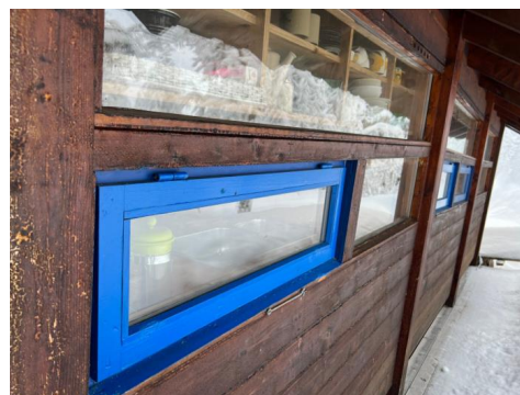
Skjevheter i vegger
