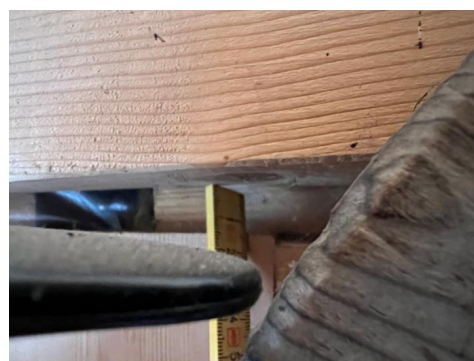
Glippe på oppmot 15 mm utifra opprinnelig posisjon
