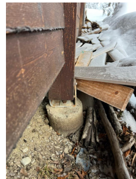
Skjevhet/utgliding av fundament
