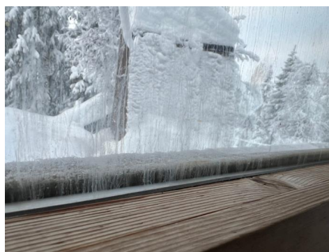
Bemerket punkterte vindu
