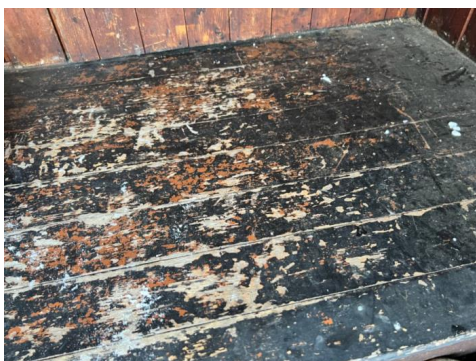
Vedlikeholdsbehov av inngangsparti
