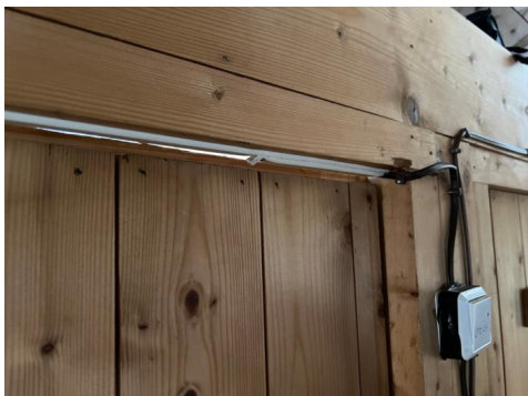
Avvik på ytterdør, synlig glippe/luftlekkasje
