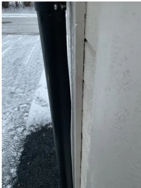
Frostsprengh i nedløpsrør.
