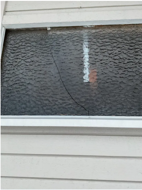
Sprekk i vindu på garasje.
