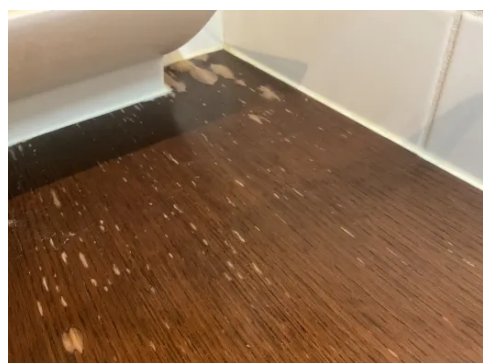
Fuktskader på innredning.
