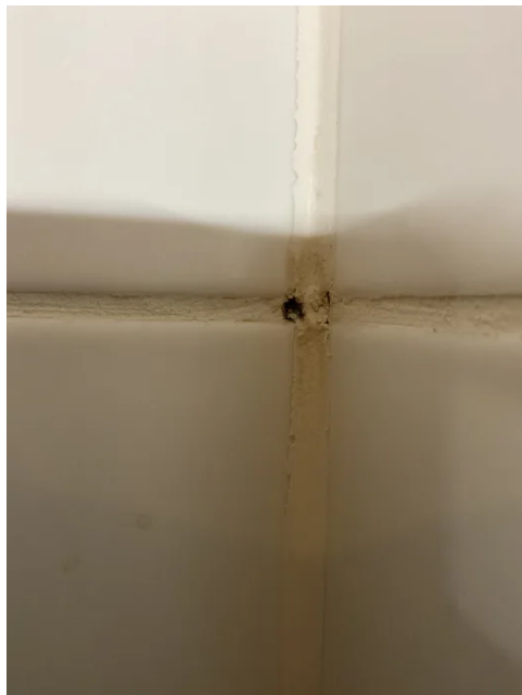
Hull i fuger ved badekar.
