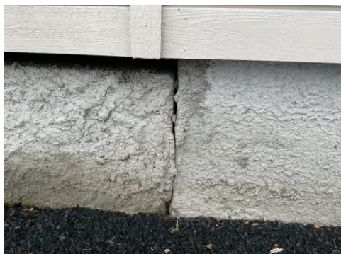
Sprekker i grunnmur/ringmur.
