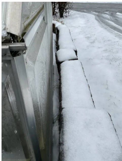
Skjevheter i støttemur.
