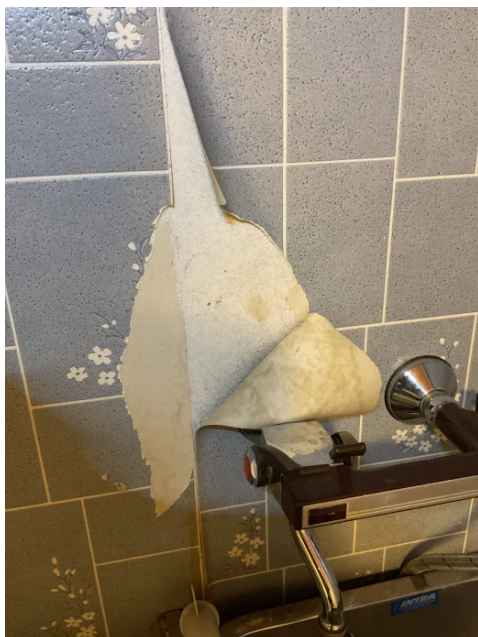
Ødelagt tappet på vegg
