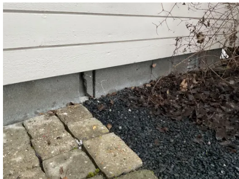
Sprekker i grunnmur/ringmur.
