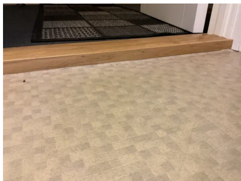
Manglende fall og lekkasjesikkring.
