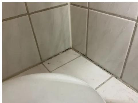
Sprekker i fug mellom gulv og vegg.
