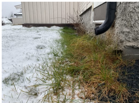
Fall inn mot grunnmur.
