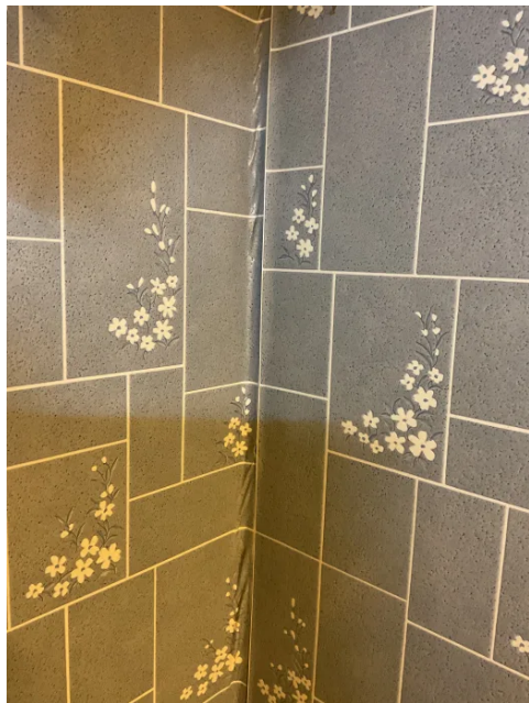
Ødelagt tappet på vegg
