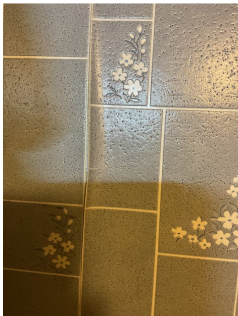
Løse skjøter på tapet.
