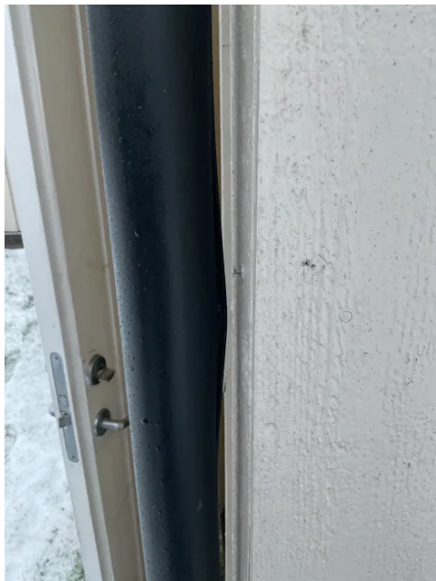
Frostsprengh i nedløpsrør.
