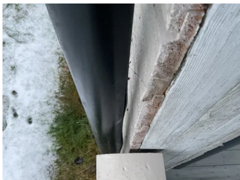
Frostspreng i nedløpsrør.
