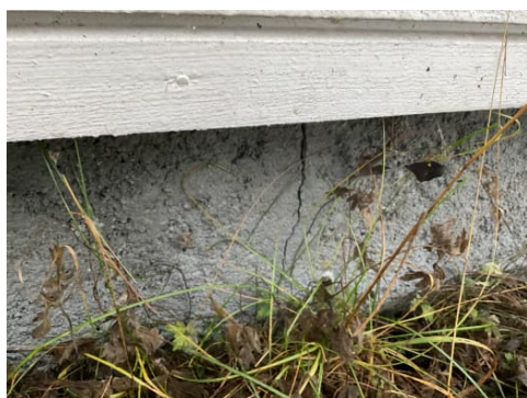
Sprekker i grunnmur/ringmur.
