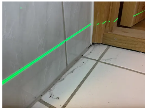
Sprekker i fug mellom gulv og vegg.
