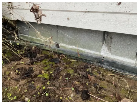
Sprekker i grunnmur/ringmur.
