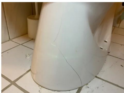
Sprekk i toalett.
