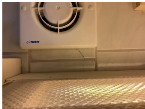
Sprekk i flis.
