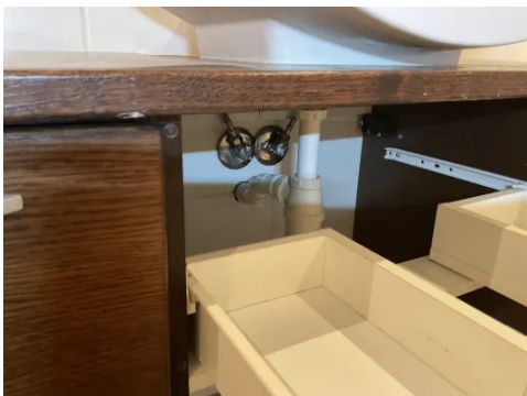
Avløpsrør bad 1. etg .
