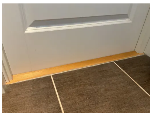
Manglende tilluft ved dør.
