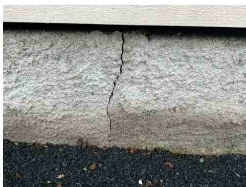
Sprekker i grunnmur/ringmur.
