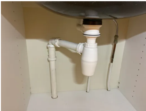
Avløpsrør bad i kjeller.
