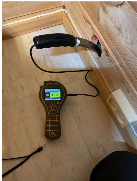
Fuktmåling i vegg mot terreng.
