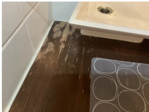
Fuktskader på innredning.
