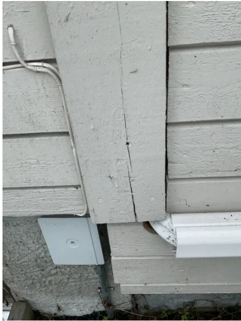
Sprekk i panel.
