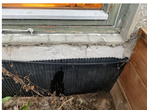
Sprekker i grunnmur/ringmur.
