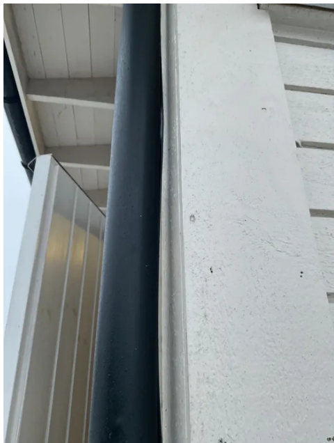
Frostsprengh i nedløpsrør.
