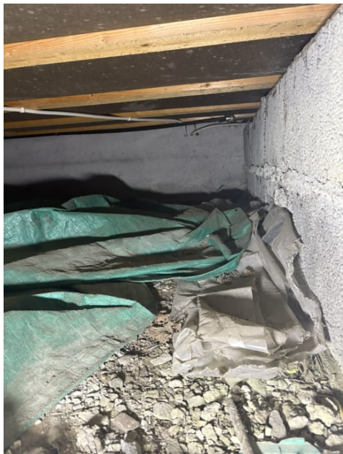
Manglende fuktsperre mot grunnen.
