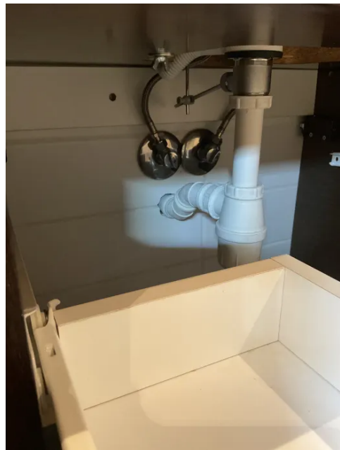
Manglende tetting rundt gjennomføring i vegg.
