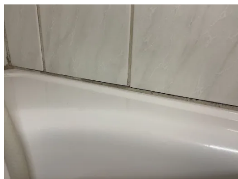
Sprekker i fug mellom badekar og vegg.
