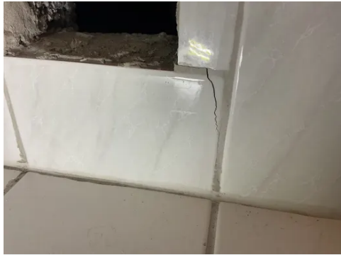
Sprekk i flis på innbygget badekar.
