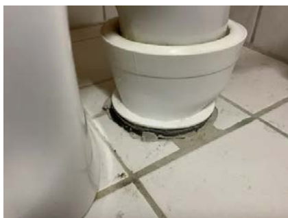
Manglende tetting gjennom gulv på wc.
