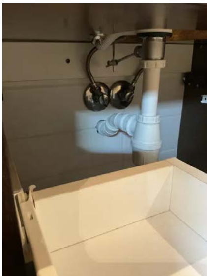
Manglende tetting rundt gjennomføring i vegg.
