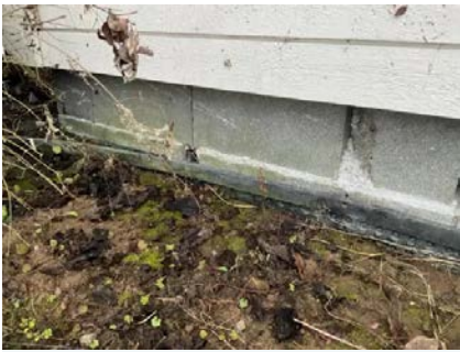
Sprekker i grunnmur/ringmur.
