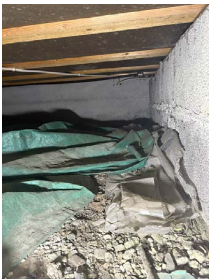
Manglende fuktsperre mot grunnen.
