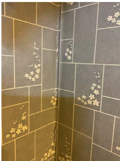
Ødelagt tappet på vegg
