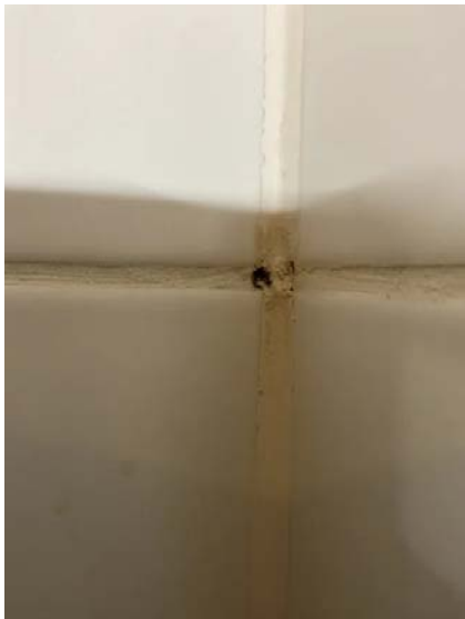
Hull i fuger ved badekar.
