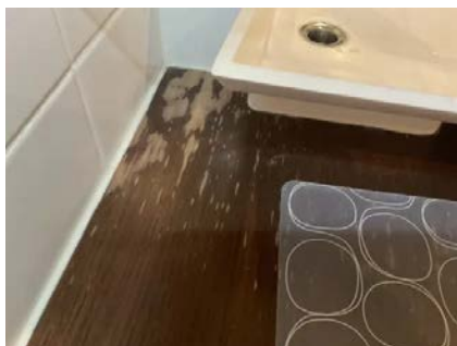
Fuktskader på innredning.
