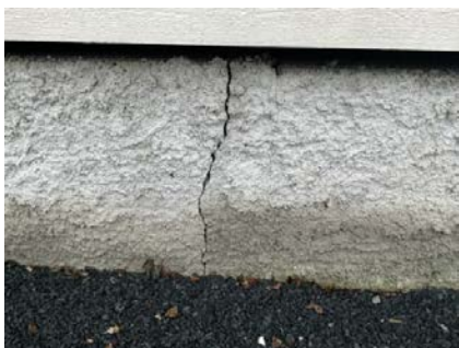
Sprekker i grunnmur/ringmur.
