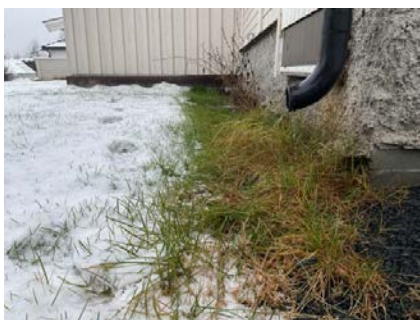
Fall inn mot grunnmur.
