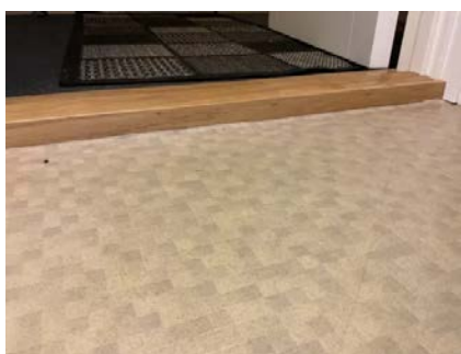
Manglende fall og lekkasjesikkring.
