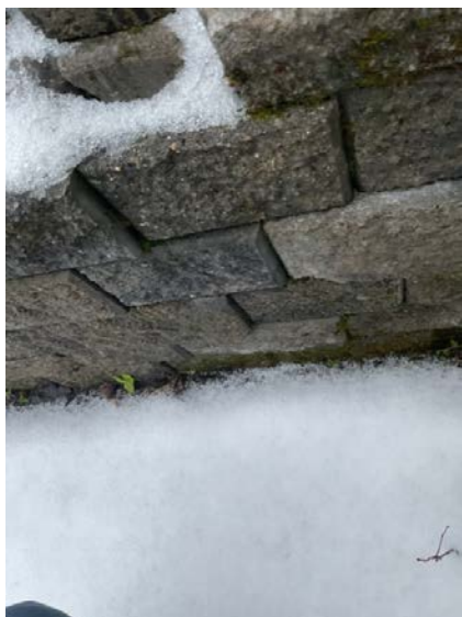
Skjevheter i støttemur.
