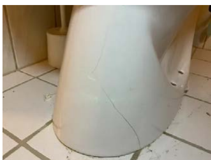
Sprekk i toalett.
