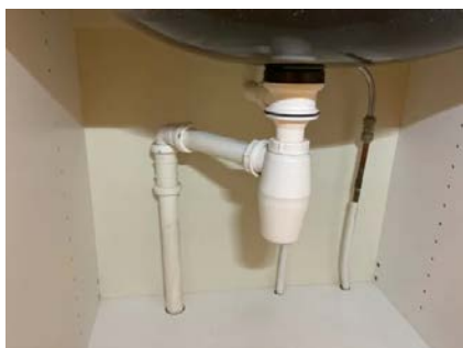
Avløpsrør bad i kjeller.
