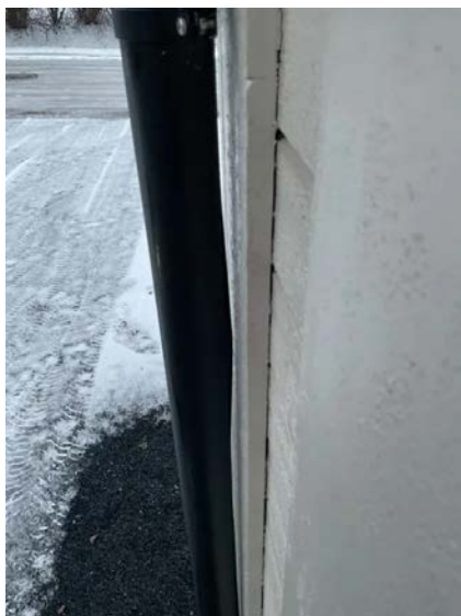
Frostspreng i nedløpsrør.
