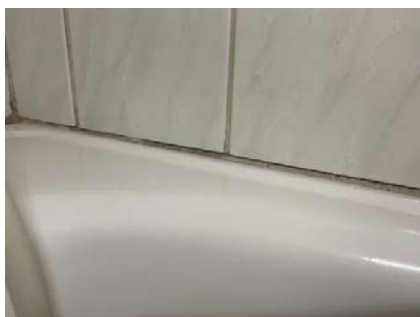
Sprekker i fug mellom badekar og vegg.
