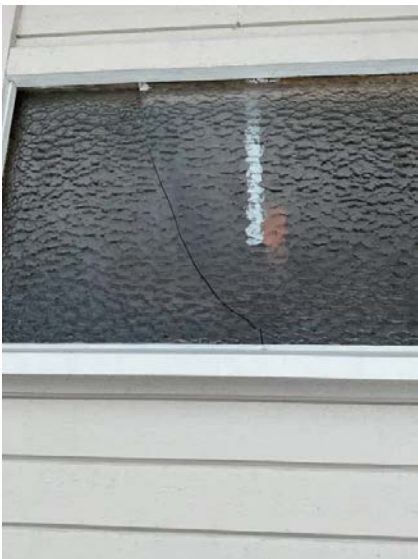
Sprekk i vindu på garasje.
