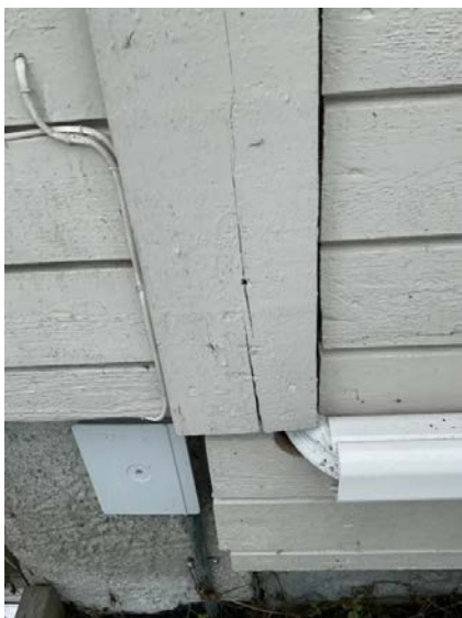
Sprekk i panel.
