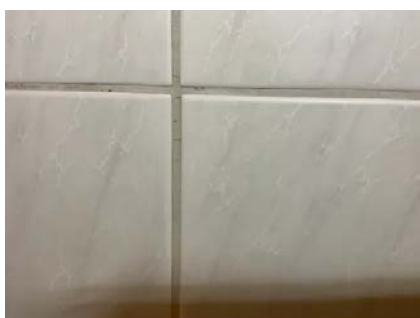
Sprekker i fuger på vegg.
