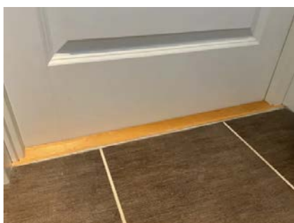
Manglende tilluft ved dør.
