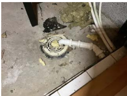
Sluk i teknisk rom med avløp fra bad.
