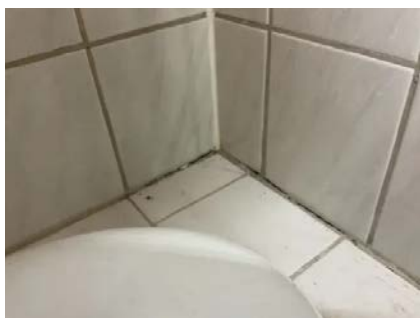
Sprekker i fug mellom gulv og vegg.
