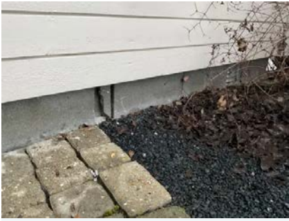
Sprekker i grunnmur/ringmur.
