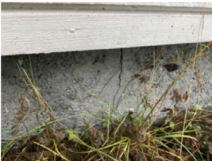
Sprekker i grunnmur/ringmur.
