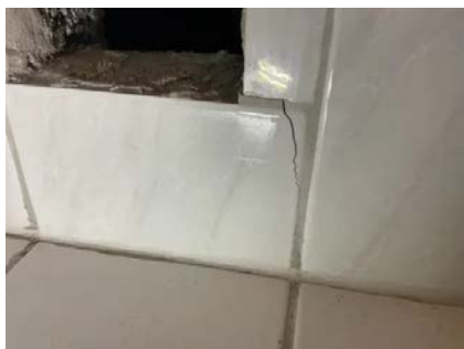
Sprekk i flis på innbygget badekar.
