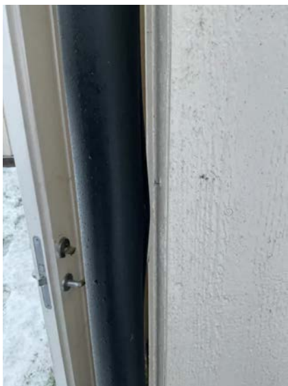
Frostspreng i nedløpsrør.
