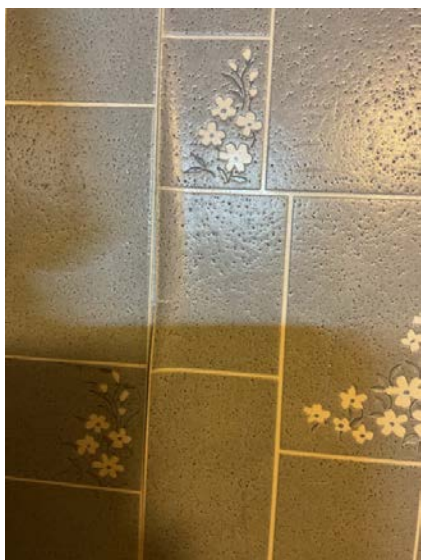
Løse skjøter på tapet.
