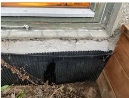
Sprekker i grunnmur/ringmur.
