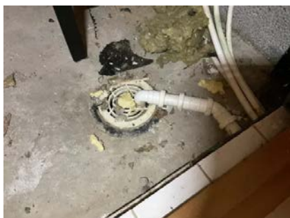
Sluket i teknisk rom.
