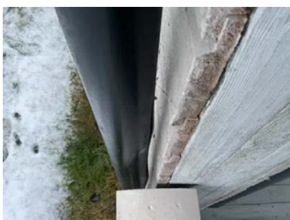
Frostspreng i nedløpsrør.
