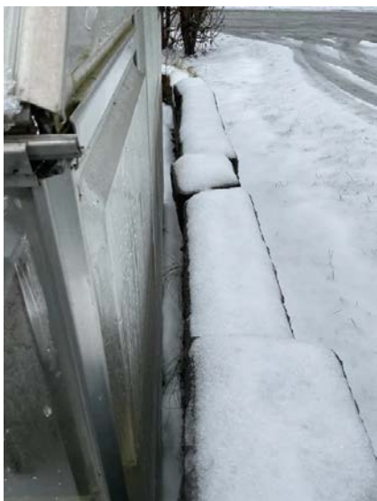
Skjevheter i støttemur.
