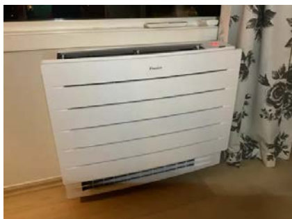
Luft/luft varmepumpe montert i stue 1. etg
