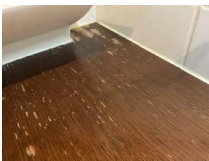
Fuktskader på innredning.
