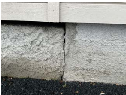
Sprekker i grunnmur/ringmur.
