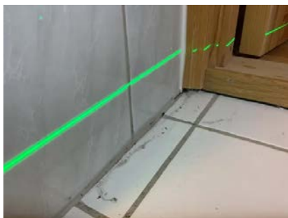
Sprekker i fug mellom gulv og vegg.
