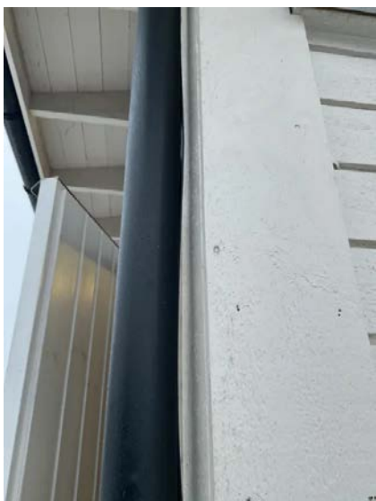
Frostspreng i nedløpsrør.
