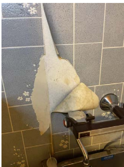
Ødelagt tappet på vegg
