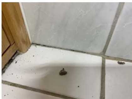
Sprekker i fug mellom gulv og vegg.
