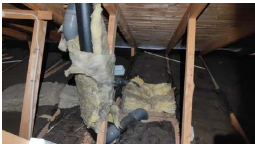
Mangelfullt isolerte rør.
