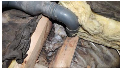
Fuktskade i himlingen over toalettrommet.
