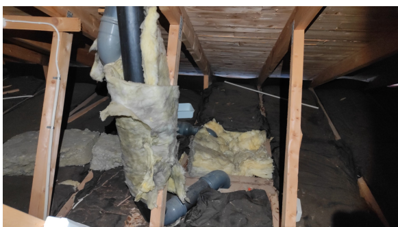
Mangelfullt isolerte rør.
