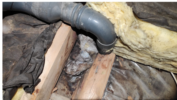
Fuktskade i himlingen over toalettrommet.
