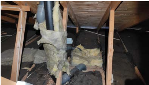
Mangelfullt isolerte rør.
