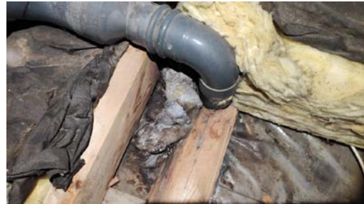
Fuktskade i himlingen over toalettrommet.
