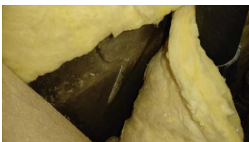
Synlig kondens bak plast.
