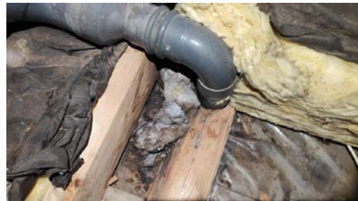
Fuktskade i himlingen over toalettrommet.
