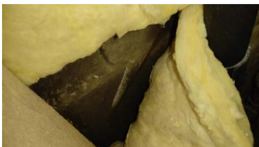
Synlig kondens bak plast.
