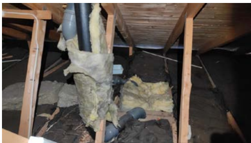
Mangelfullt isolerte rør.
