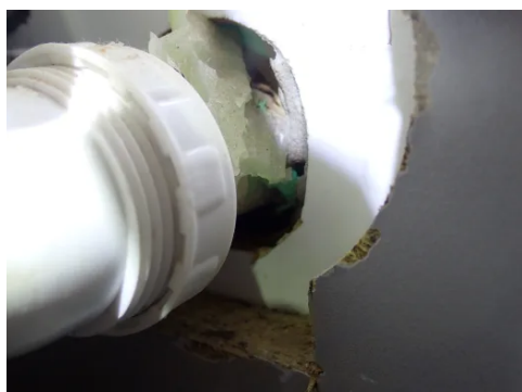
Utett rørgjennomføring i vegg under servant.
