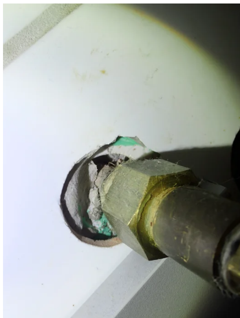
Utett rørgjennomføring i vegg under servant.
