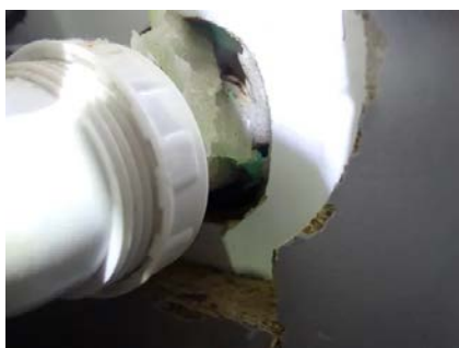
Utett rørgjennomføring i vegg under servant.
