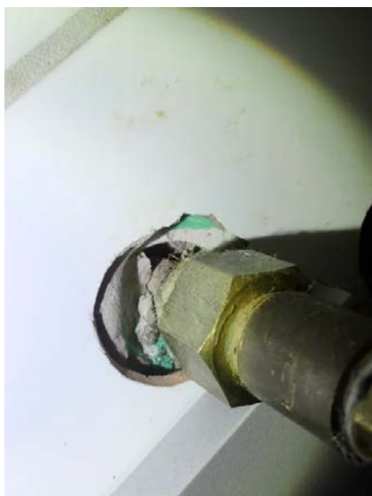
Utett rørgjennomføring i vegg under servant.
