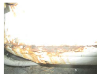
En del rustskader på bereder.
