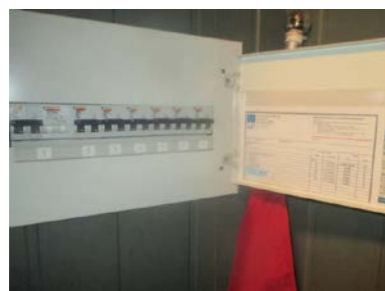
Sikringstavla er plassert i vindfang
