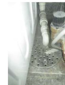
Sluk i nisje ved vaskemaskin og bereder.
