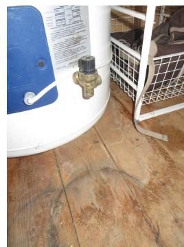
Det er ikke etablert tilfredsstillende avrenningsmulighet fra berederens sikkerhetsventil.
