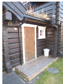
Merk ytre påkjenninger på dører som står uten overdekkende tak. Større slitasje på nedre del av dør.
