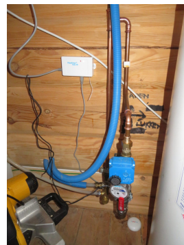
Hovesstoppekran og waterstop - magnetventil med føler.
