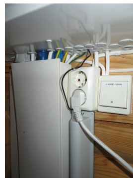
Berederen er tilknyttet det elektriske anlegget via enklere kontakt - dette er ikke ihht gjeldende forskifter.
