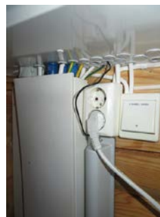
Berederen er tilknyttet det elektriske anlegget via enklere kontakt - dette er ikke iht gjeldende forskrifter.
