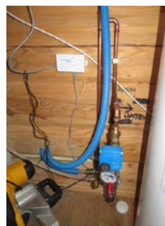
Hovesstoppekran og waterstop - magnetventil med føler.
