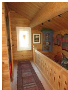
Rekkverk i 2.etg måler 73 cm høyde - dette er 17 cm under minstekravet på 90 cm.
