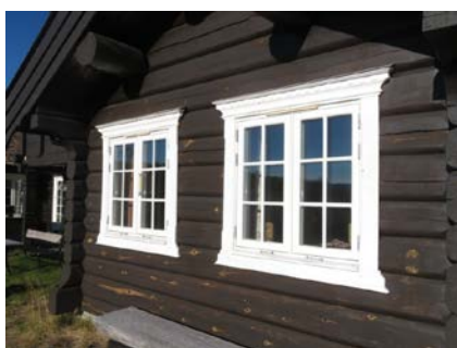
Dels noe slitte overflater på utv. belistning.
