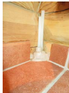
Det ses benyttet membran opp på vegg bak fliser.
