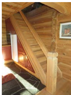
Trapp til 2.etg - Det ses å mangle rekkverk under håndløper samt at det ikke er montert håndløper på vegg.
