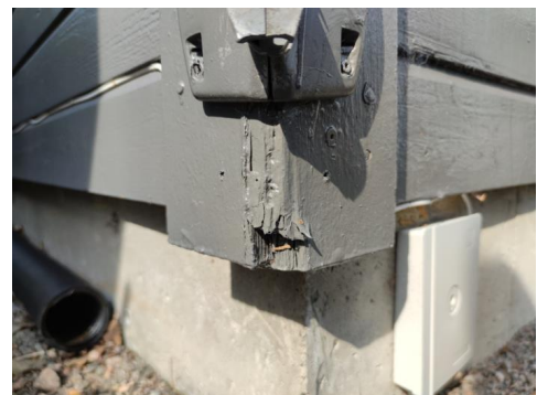
Noe råte i hjørnekasse.
