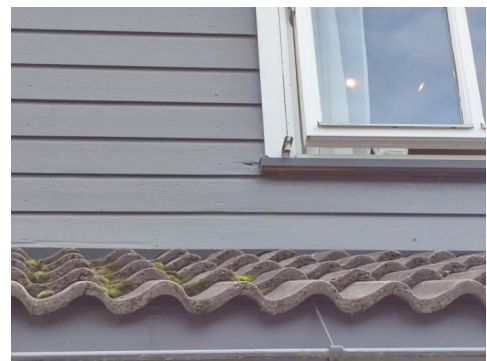
Noe råte i kledningsbord mot vindu.
