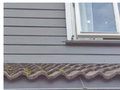
Noe råte i kledningsbord mot vindu.
