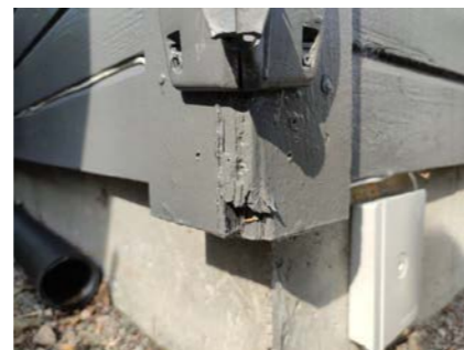
Noe råte i hjørnekasse.
