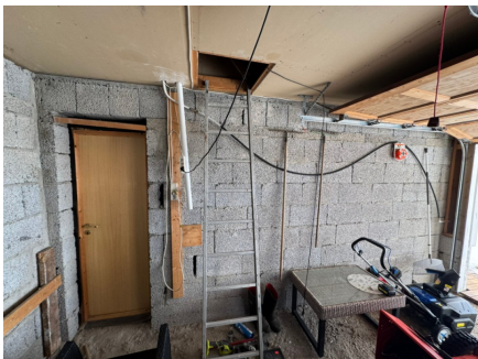
Vannledning i garasjen.
