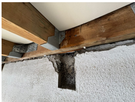
Lekkasje i overgangen mellom gulvet og vegg.
