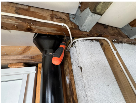
Eksempel på råteskader.
