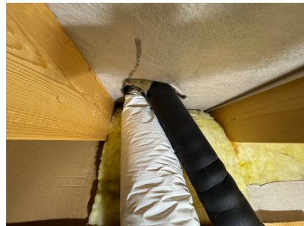
Utett gjennomføring i undertaket.
