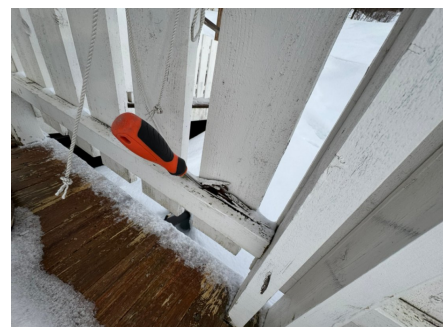
Råteskade i rekkverk på altan.
