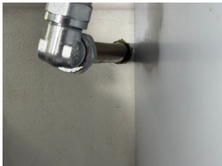
Utett rørgjennomføring under servanten.
