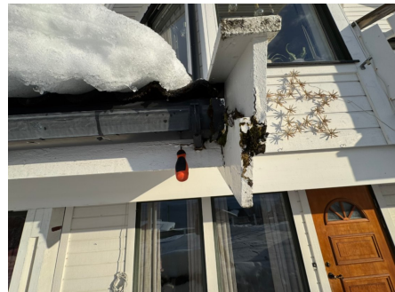
Eksempel på råteskader.
