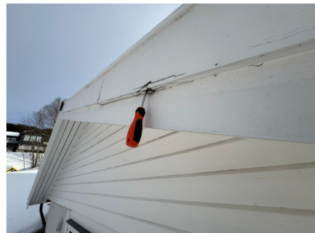
Eksempel på råteskader.
