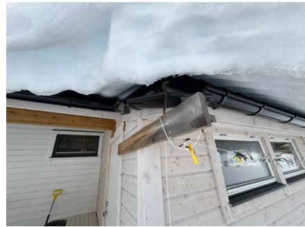
Utettheter i takrennen ved boden.
