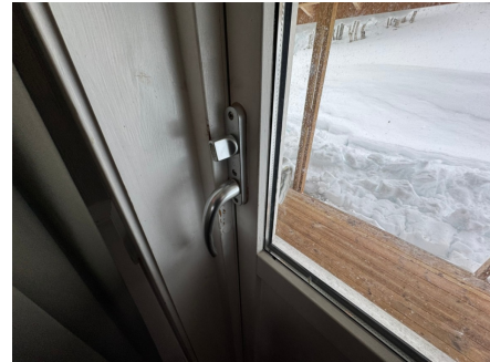
Det er ikke tett mellom dør og karm.
