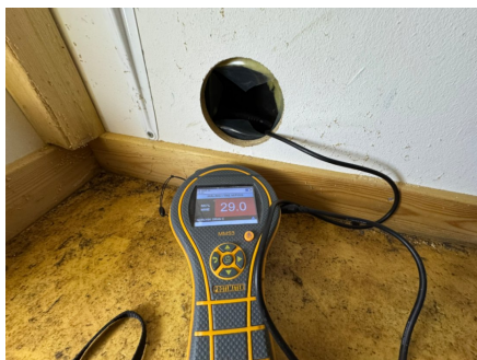
Fuktmåling i vegg fra bod mot terreng.
