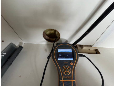
Fuktmåling fra kjøkkenet mot dusjkabinettet.
