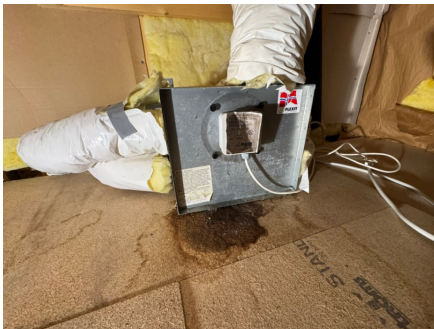
Fuktmerker i sponplaten under avtrekksviften.
