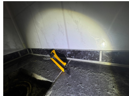
Det er ikke fuget mellom baderomsplatene og bunnen.
