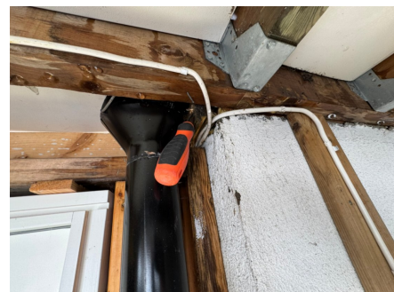
Lekkasje i overgangen mellom gulvet og vegg.
