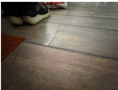
Fuktsvelling i laminatgulvet i gangen.
