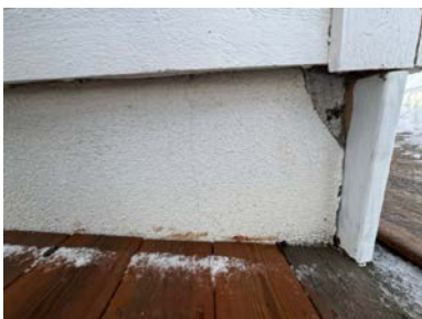
Eksempel på riss i grunnmuren.
