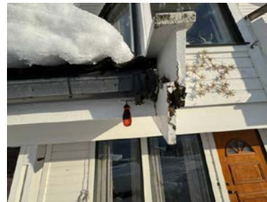
Eksempel på råteskader.
