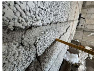
Store sprekker i grunnmuren til garasjen mot sør.
