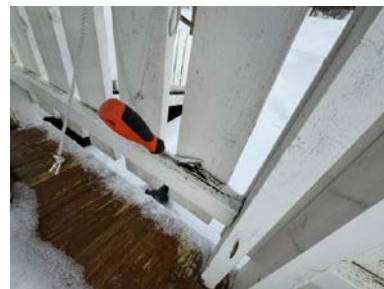
Råteskade i rekkverk på altan.
