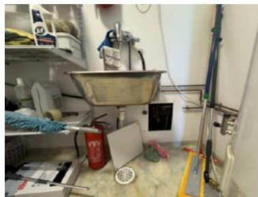
Inspeksjonsluke i våtsonen ved skyllekaret.
