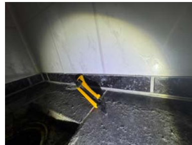
Det er ikke fuget mellom baderomsplatene og bunnlisten.
