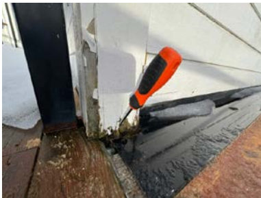
Eksempel på råteskader.
