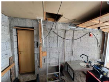
Vannledning i garasjen.
