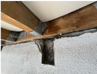
Lekkasje i overgangen mellom gulvet og veggen.
