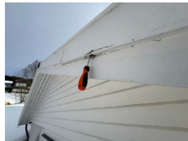
Eksempel på råteskader.
