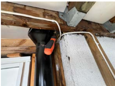
Eksempel på råteskader.
