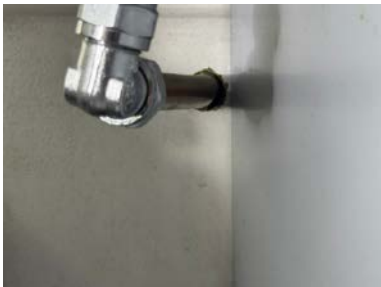
Utett rørgjennomføring under servanten.
