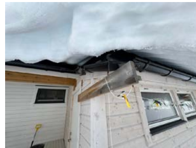
Utettheter i takrennen ved boden.
