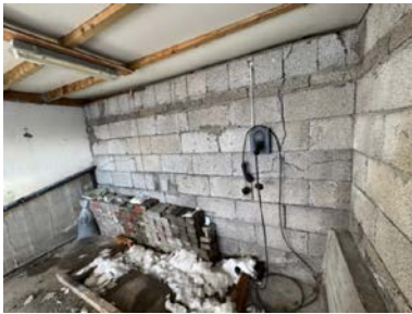
Store sprekker i grunnmuren til garasjen mot sør.
