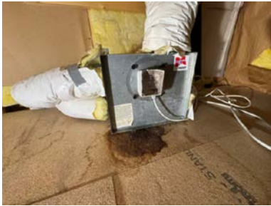
Fuktmerker i sponplaten under avtrekshviten.
