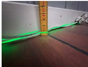
Måling utført på soverommet på loftet.
