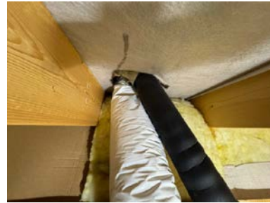
Uttett gjennomføring i undertaket.
