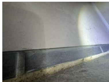
Det er ikke bunnlist i nedkanten av baderomsplatene.
