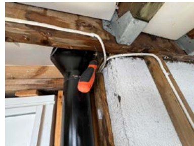
Lekkasje i overgangen mellom gulvet og veggen.
