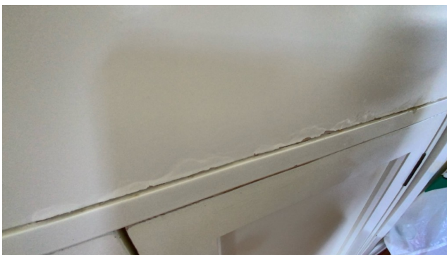
Litt svellinger/avskalling av maling.
