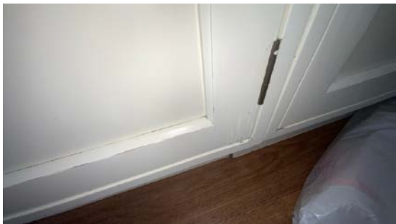
Litt svellinger/avskalling av maling.
