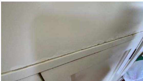
Litt svellinger/avskalling av maling.
