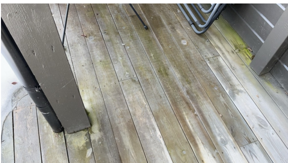
Slitasje på overflater.
