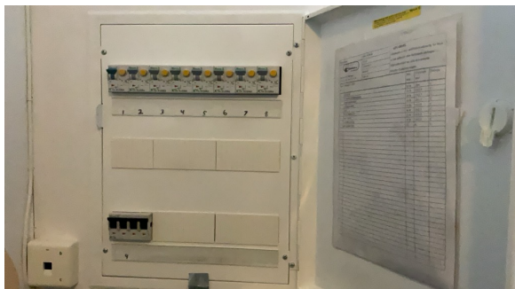
Sikringsskap plassert på bod.
