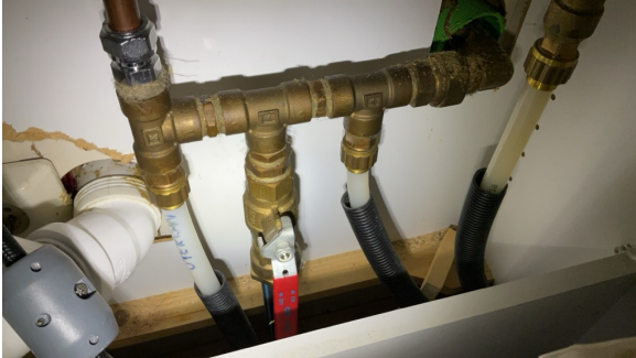
Stoppekran plassert i kjøkkenbenk.
