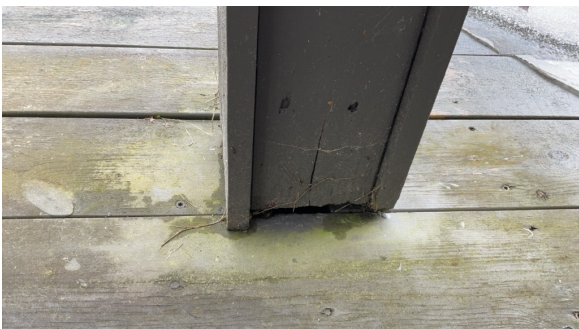
Liten råteskade på søyle.
