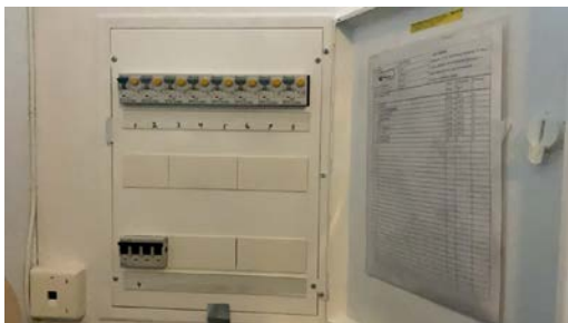
Sikringsskap plassert på bod.
