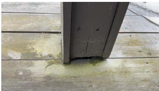
Liten råteskade på søyle.
