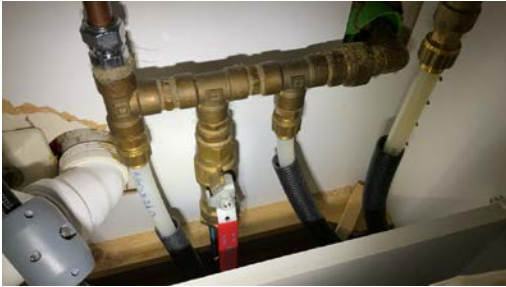
Stoppekran plassert i kjøkkenbenk.
