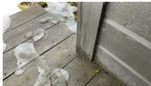
Liten råteskade på plassbygget kasse.
