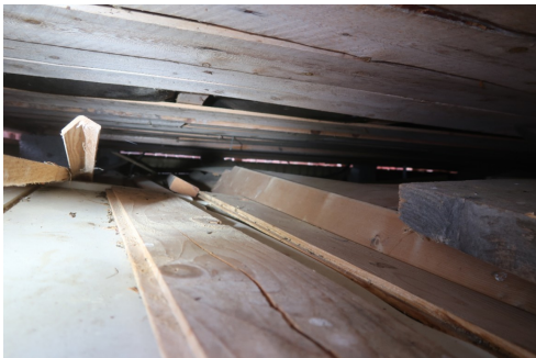
Bilde viser utettheter i bjelkelag og lagring av treverk i krypekjeller
