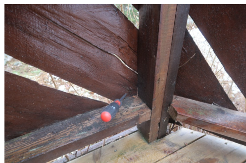
Bilde viser eksempel på råteskade i rekkverk
