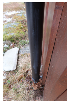
Bilde viser frostsprengt nedløpsrør
