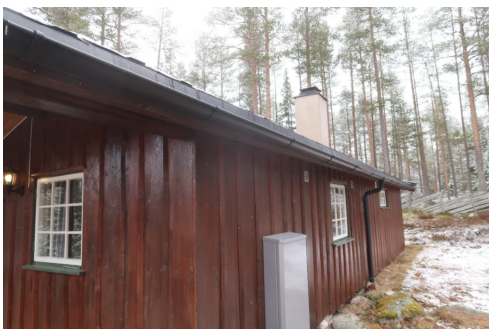
Bilde viser deformasjoner på takrenner
