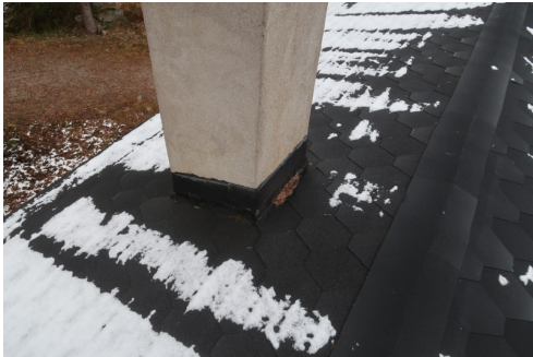
Bilde viser eksempel på manglende takstige
