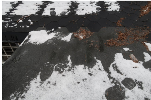
Bilde viser at vann blir liggende igjen på yttertaket på grunn av lav takvinkel og ujevnheter.
