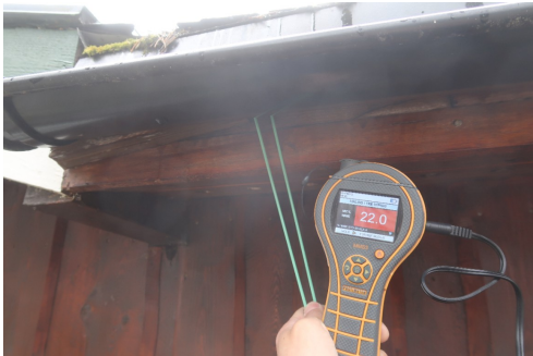
Bilde viser fuktmåling ved påvist lekkasje i nedkant av yttertaket mot nord.
