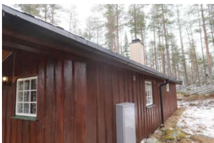
Bilde viser deformasjoner på takrenner
