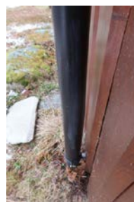
Bilde viser frostsprengt nedløpsrør
