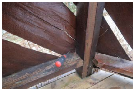
Bilde viser eksempel på råteskade i rekkverk
