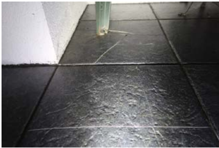
Bilde viser skadede fliser under ildsted i stue
