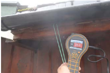
Bilde viser fuktmåling ved påvist lekkasje i nedkant av yttertaket mot nord.
