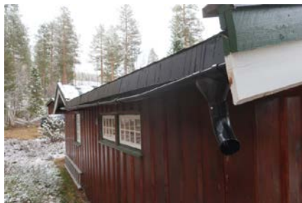
Bilde viser skader på takrenne og manglende nedløpsrør
