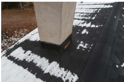
Bilde viser eksempel på manglende takstige
