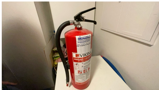
Brannslukkeapparat er under 10 år.
