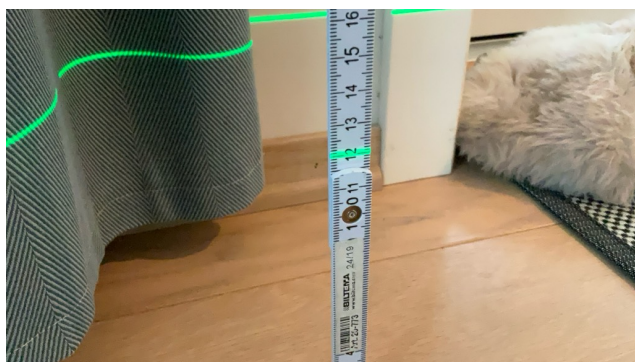
Utgangsstråle laser er 13,5 cm. Foto viser største målte skjevhet i stue kjøkken på 14 mm.
