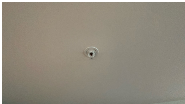
Leiligheten har sprinkleranlegg.
