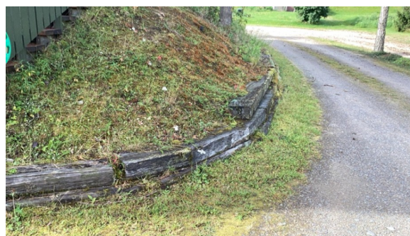
Eksempel på råteskade.
