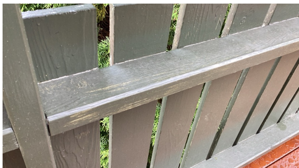
Eksempel på dårlig malingsdekk.
