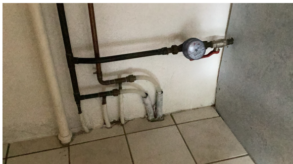
Eget vanninntak med måler og stoppekran på vaskerom
