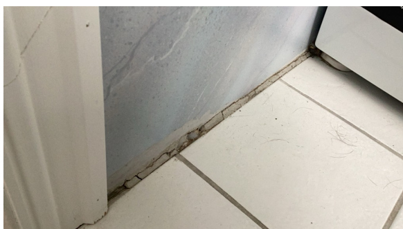
Det sprekker opp i fuger.
