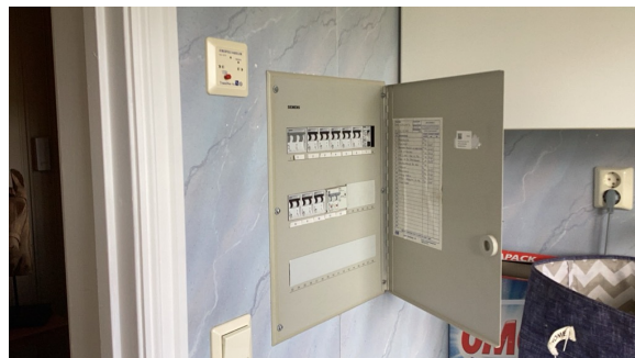
Sikringsskap på vaskerom.
