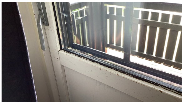
Balkongdør har noe slitasje på overflater.
