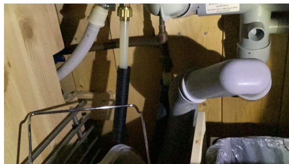
Det er ikk forsegling mellom vannrør og varerør på kjøkken.
