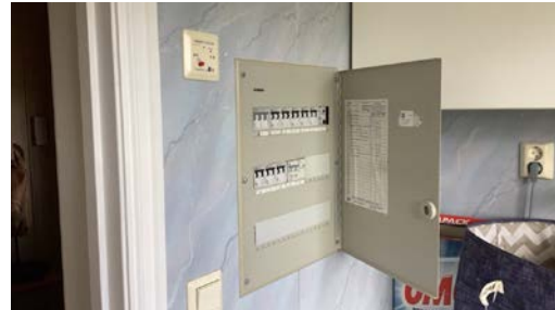
Sikringsskap på vaskerom.
