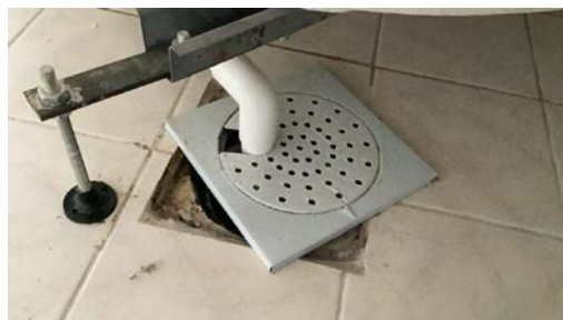
Slukrist ligger løst over sluk.
