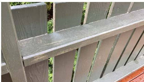
Eksempel på dårlig malingsdekk.
