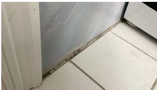
Det sprekker opp i fuger.
