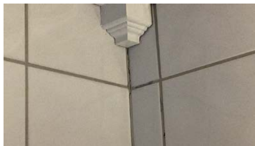
Det sprekker stedvis opp i hjørner.
