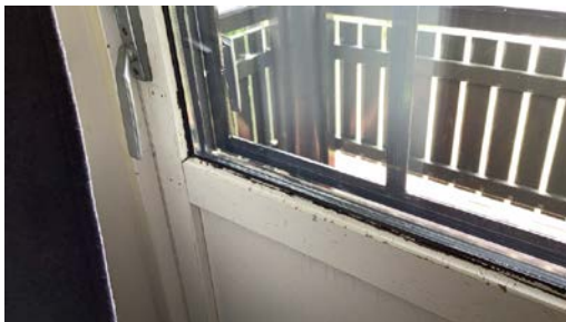
Balkongdør har noe slitasje på overflater.
