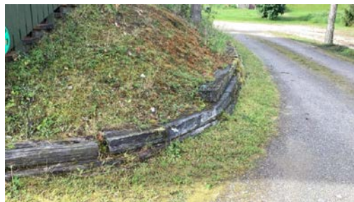
Eksempel på råteskade.
