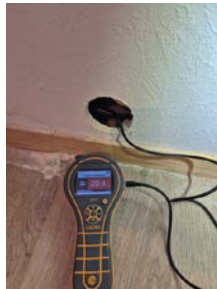
Høy fuktighet ved hulltaking på soverom.
