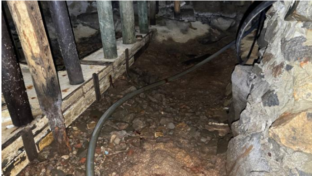
Bilde viser søyler som står direkte på grunn/betong og utsatt for fukt og råteskader.
