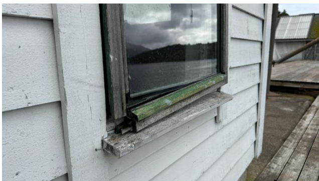
Bilde viser et vindu som bør skiftes.
