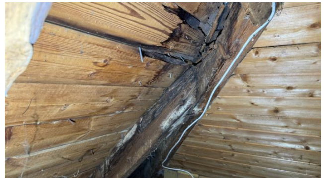
Bilde viser råteskader i takkonstruksjonen.
