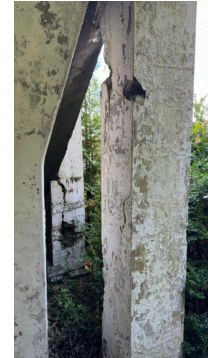
Rust/korrosjon i søyle/betongtrapp utvendig.
