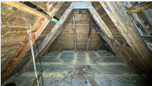
Bilde viser spor etter mit/borrebiller i takkonstruksjonen.
