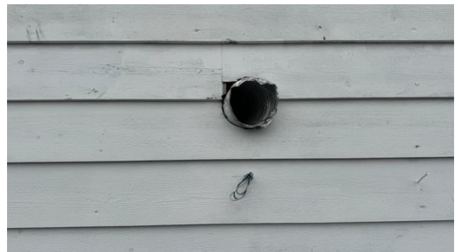
Bilde viser avslutning utvendig for avtrekk på kjøkken.
