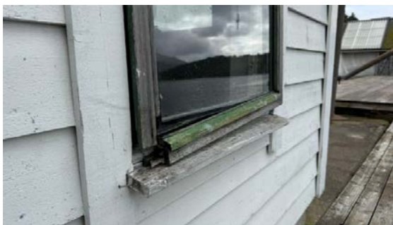
Bilde viser et vindu som bør skiftes.
