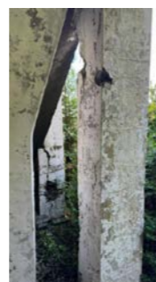
Rust/korrosjon i søyle/betongtrapp utvendig.
