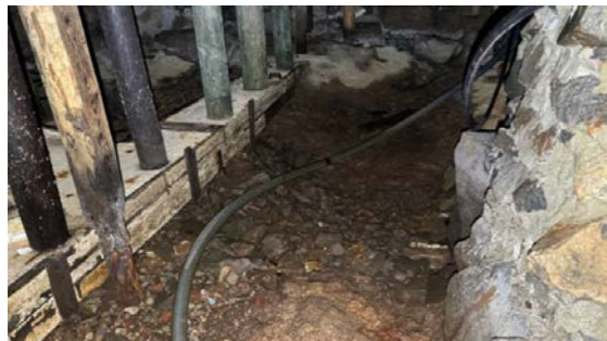
Bilde viser søyler som står direkte på grunn/betong og utsatt for fukt og råteskader.
