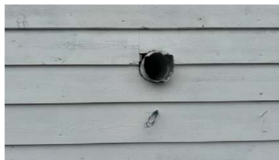
Bilde viser avslutning utvendig for avtrekk på kjøkken.
