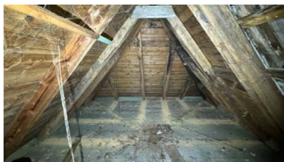
Bilde viser spor etter mit/borebiller i takkonstruksjonen.
