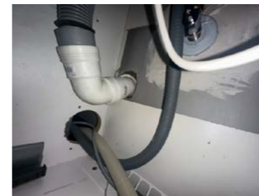
Røropplegg i kjøkkenbenk
