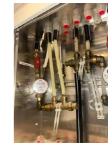
Samleskap med rørkurser og stoppekraner
