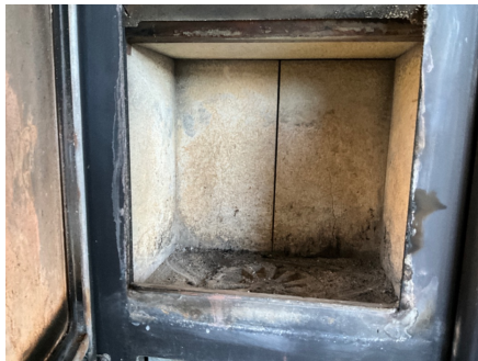
Mindre oppsprekking på ildfast stein
