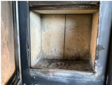
Mindre oppsprekking på ildfast stein
