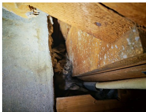
Delvis mindre åpning i brannskille mot nabo mot nord på loft (til høyre for pipe)
