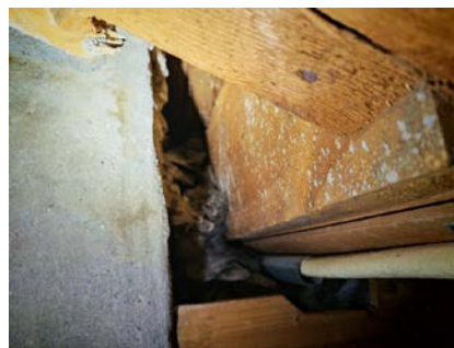
Delvis mindre åpning i brannskille mot nabo mot nord på loft (til høyre for pipe)
