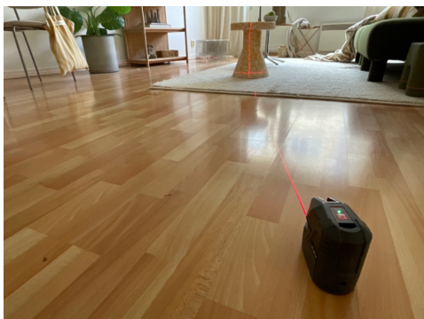
Nivellering stue, avvik ca. 15-30 mm
