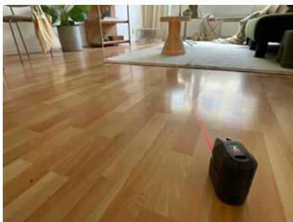
Nivellering stue, avvik ca. 15-30 mm
