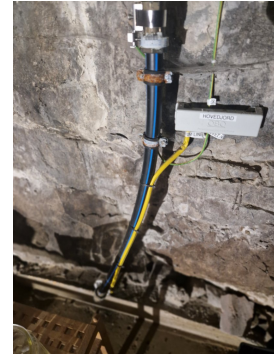
Synlig PEL/plast i kjeller til inntaksledning.
