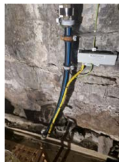
Synlig PEL/plast i kjeller til inntaksledning.
